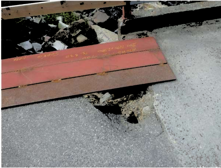
Figur 6: Erosjonsskade ved østre brukar øverste bru
