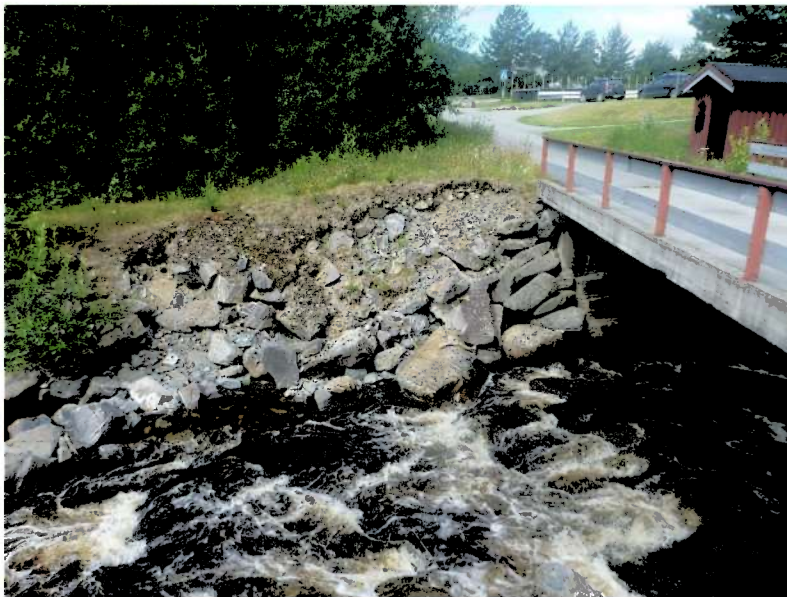
Figur 7: Erosjonsskader ved brukar vestre side øverste bru
