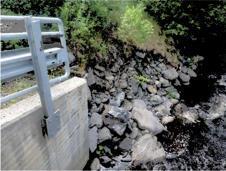
Figur 8: Erosjonsskader ved brukar nest øverste bru
