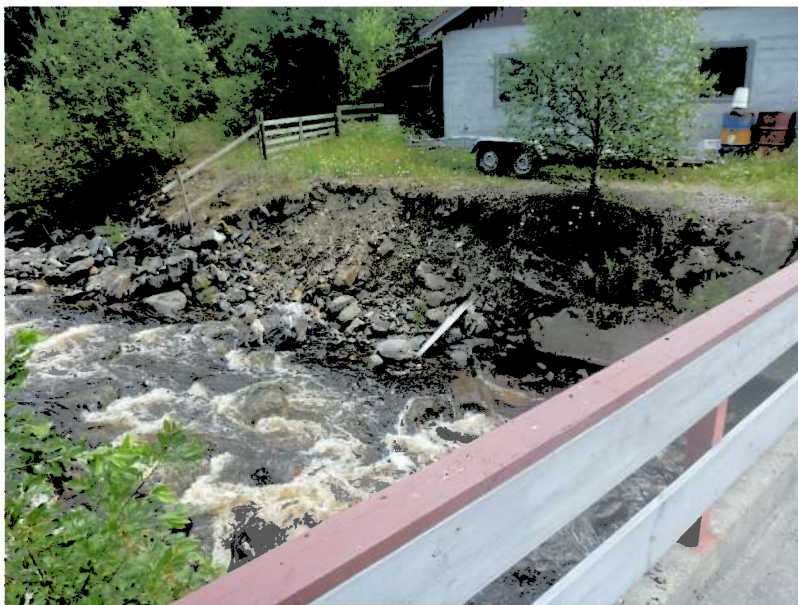
Figur 5: Erosjonsskader østre side oppstrøms øverste bru
