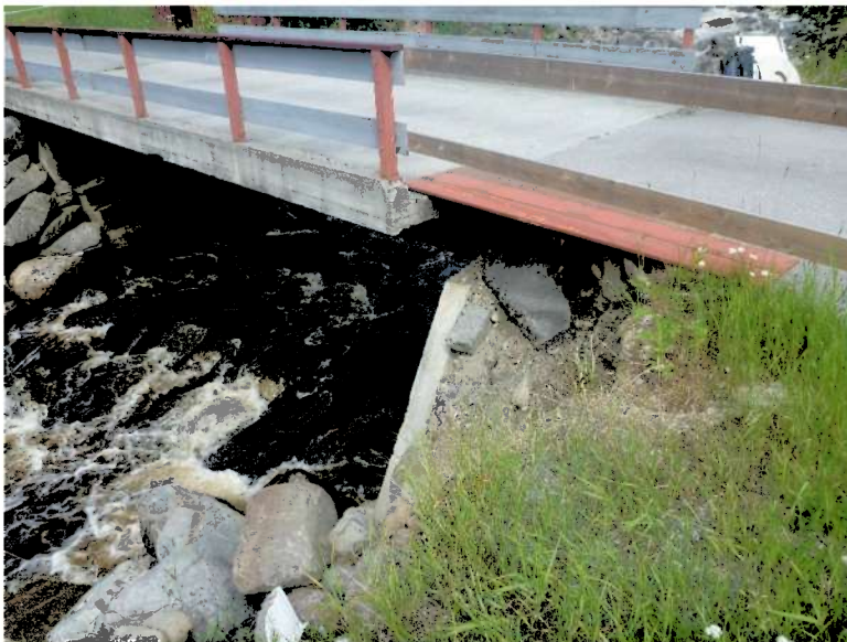
Figur 5: Erosjonsskader ved brukar øverste private bru
