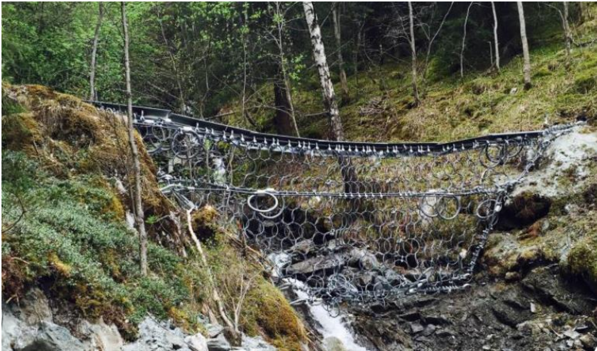
Figur 3: Flomskredgjerde i Kollobekken, Otta. www.geobrugg.com
