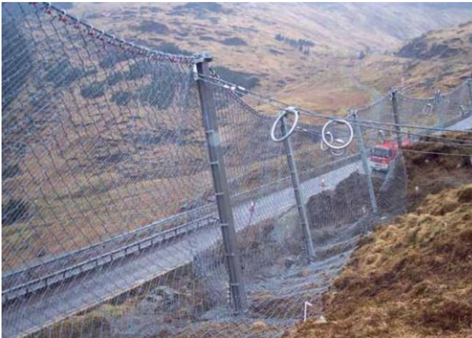
Figur 4: Nett mot grunne jordskred. www.geobrugg.com .
